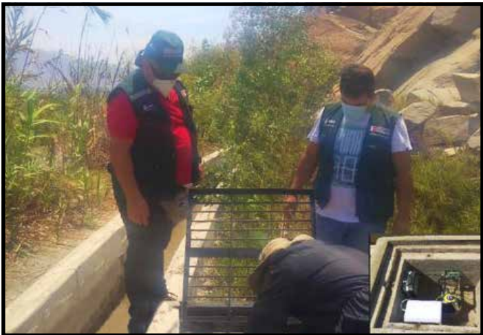
Estructura hidráulica automatizada - San Jose
