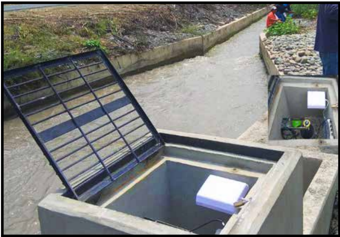
Estructura hidráulica automatizada - Quipico
