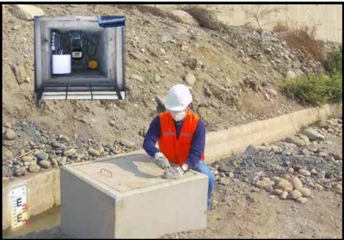
Estructura hidráulica automatizada - Mani Cañas
