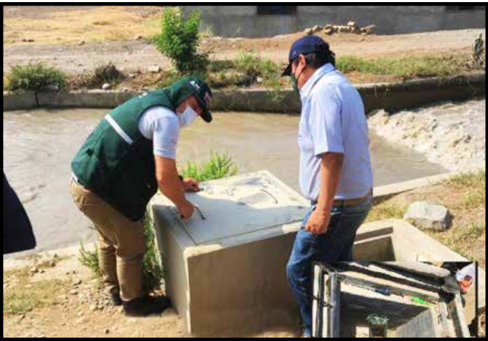
Estructura hidráulica automatizada - San Felipe
